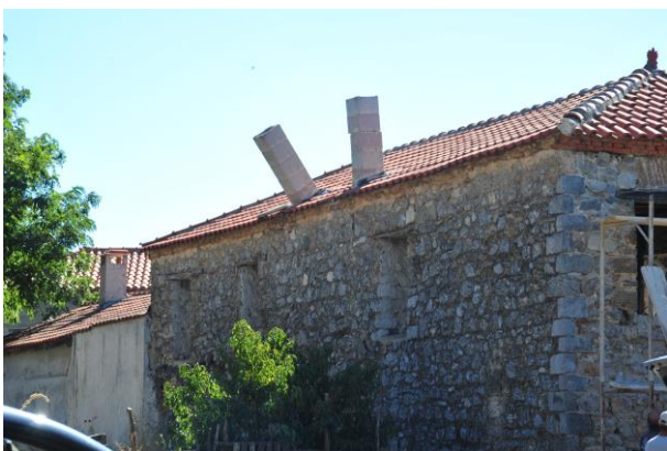
Βλάβες σε κτίριο στην Καρυά.
