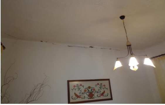
Βλάβες σε κτίριο στα Κόμνηνα.
