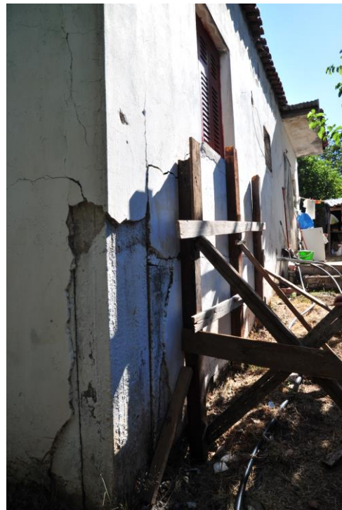
Επιδείνωση βλαβών σε κατοικίες στην Καρυά.
