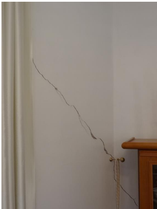
Ρηγμάτωση σε κτίριο στα Κόμνηνα.
