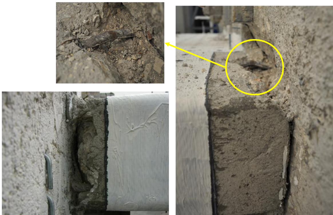
Σχήμα 141: Βλάβες υποστυλωμάτων στην βάση του δοκιμίου μετά το τέλος της δοκιμής.
