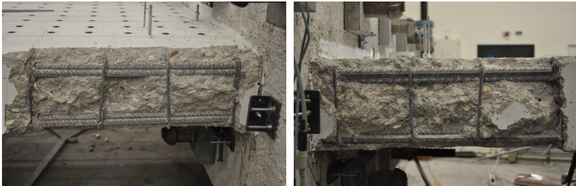
Σχήμα 95: Βλάβες υποστλωμάτων στην περιοχή των ματίσεων
