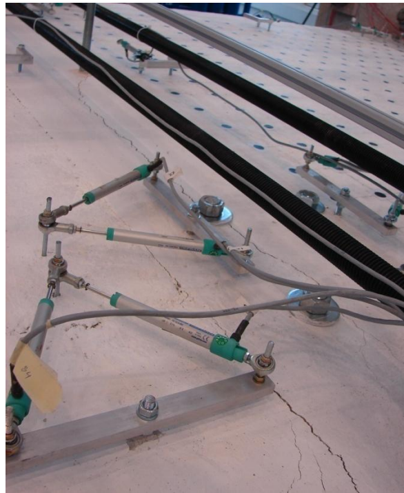
Σχήμα 160: Ρηγματώση στη δοκό βάσης 2ου ορόφου
