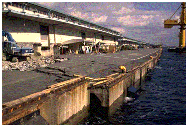
Σχήμα 1.1 Σεισμική μετατόπιση και καθίζηση του λιμενικού κρηπιδότοιχου στο λιμάνι του Kobe κατά τον σεισμό Hyogoken-Nambu (Nisee, U.C. Berkeley, Image Database Kobe 1995)
