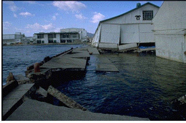
Σχήμα 1.2 Σεισμική μετατόπιση και καθίζηση του λιμενικού κρηπιδότοιχου στο λιμάνι του Kobe κατά τον σεισμό Hyogoken-Nambu (Nisee, U.C. Berkeley, Image Database Kobe 1995)
