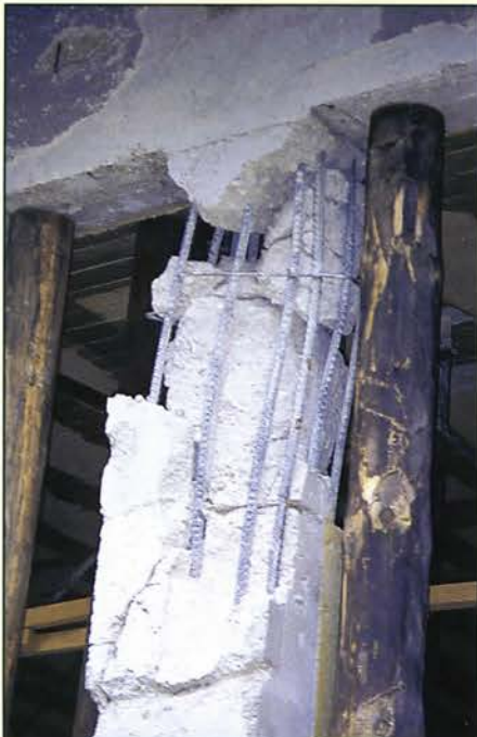
Λεπτομέρεια υποστήλωσης με κορμούς δένδρων σε πολύ σοβαρά βλαμμένο υποστυλώμα.
