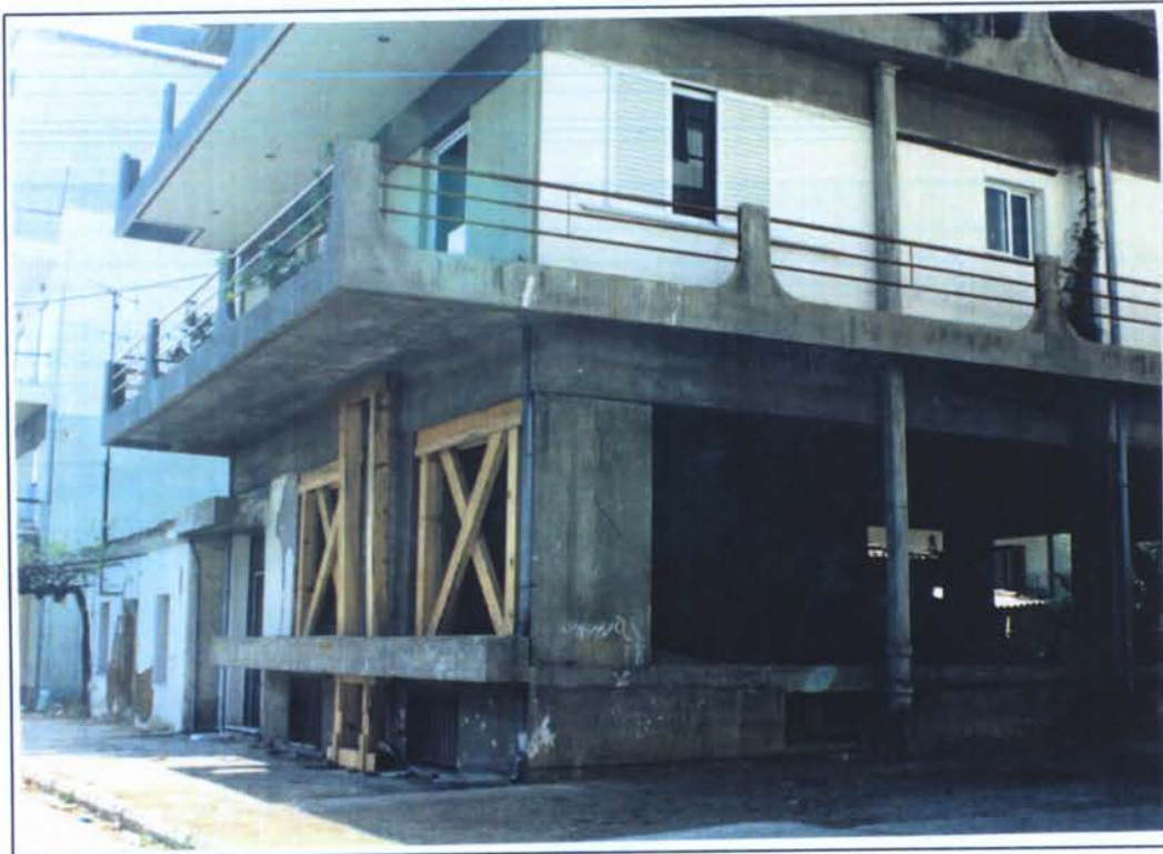
Εικ. 3.5 Ζημιές σε κατασκευές κλάσεως τριτοτάτης D και βαθμό 4 (πάνω) και 3 (κάτω).
