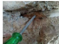
Εικόνα Β68 Μη εμφανής ξυλοδεσιά σε σήψη
