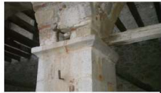
Εικόνα Β66 Θέση συμβολής τούζων
