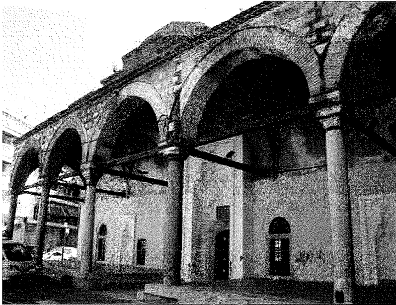
Σχήμα Π.20: Ξύλινοι ή μεταλλικοί ελκυστήρες σε τόξα, καμάρες και τρούλους βυζαντινών και οθωμανικών μνημείων
