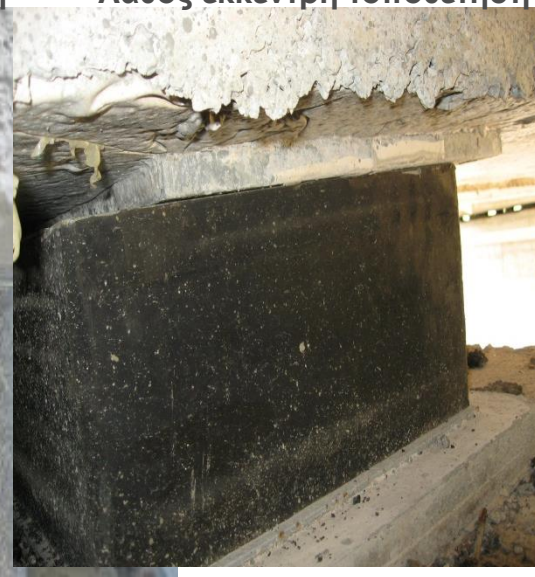
Κακή επαφή – αγκύρωση (Εφεδ. Type 5)
