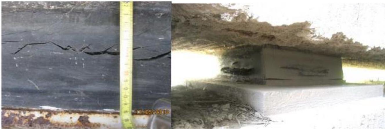
Σχ. 9, 10. Περιμετρικά σκισίματα ελαστομερούς εφεδράνων
