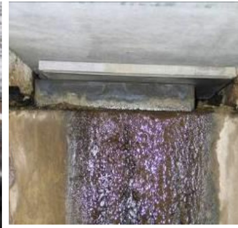
Λάθος έκκεντρη τοποθέτηση
