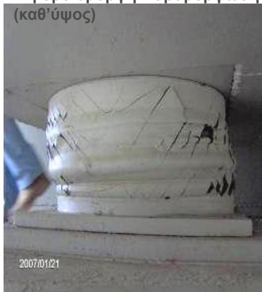
Διαρροή υλικού – ολίσθηση λαμών ενίσχυσης
