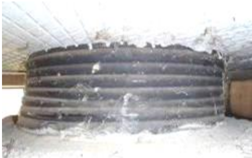
Ασύμμετρη πλευρική παραμόρφωση μεσαίας στρώσης εφεδράνου .
