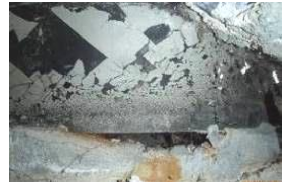
Αστοχία βουλκανισμού, λόγω κακής έδρασης και σημάδια οξείδωσης
