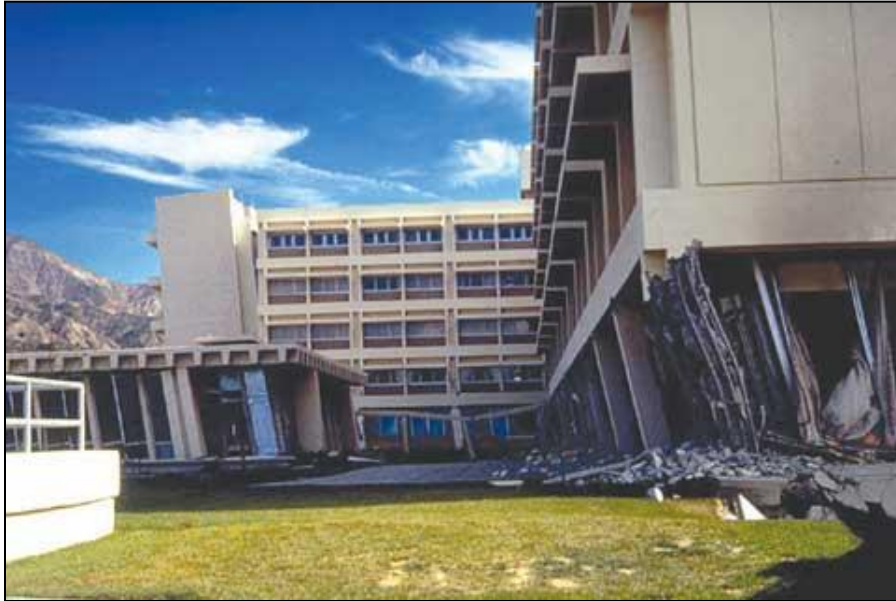
1971 San Fernando, California 5-όροφο Νοσοκομείο Olive View
