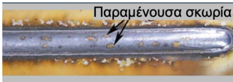
Εκτενής διάβρωση και παραμένουσα σκωρία
