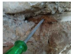
Εικόνα Β65 Μη εμφανής ξυλοδεσιά σε σήψη
