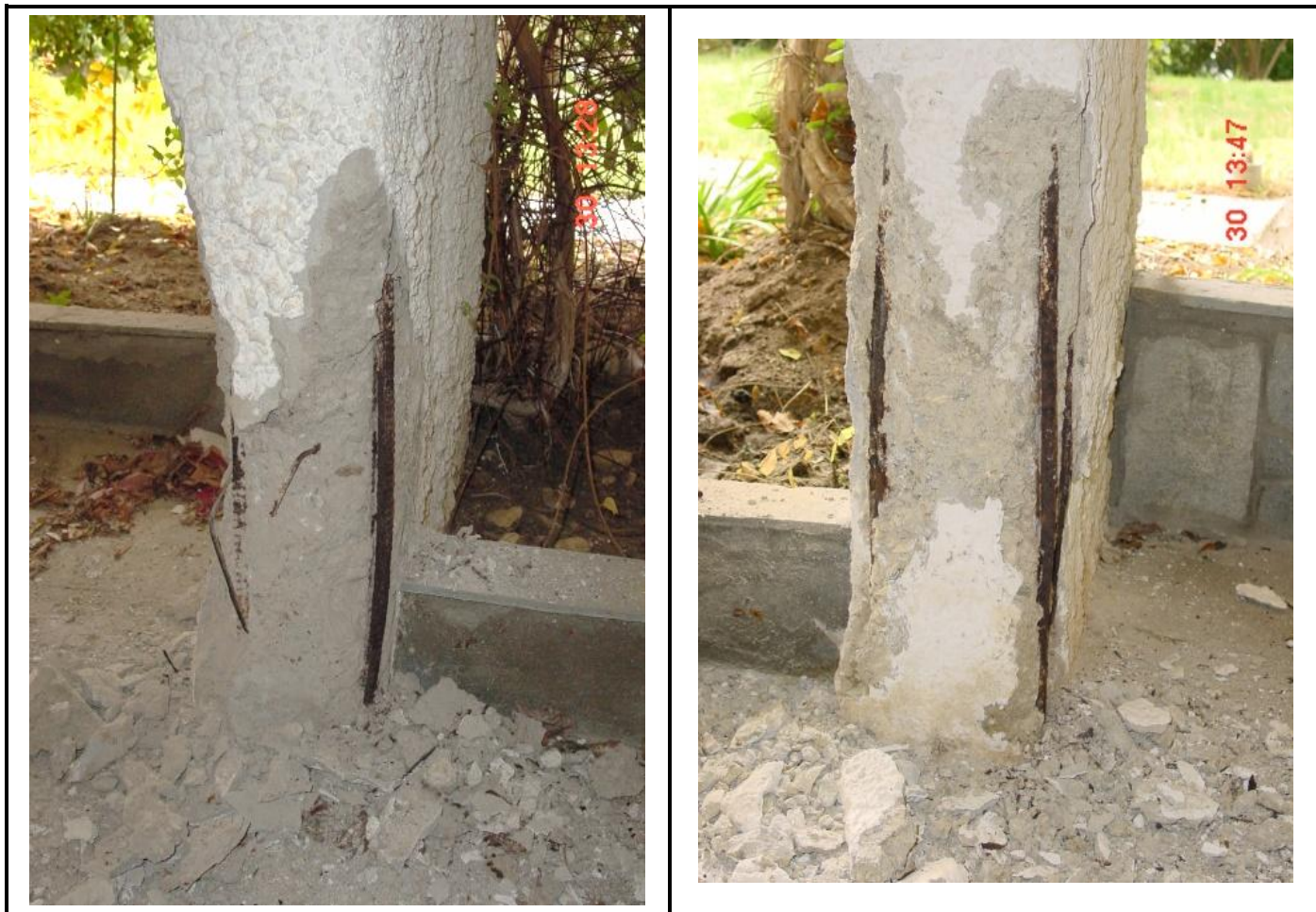
ΕΙΚΟΝΑ Δ4-13. Εύθρυπτο σκυρόδεμα σε οποιοδήποτε κατακόρυφο στοιχείο, σε συνδυασμό με απουσία συνδετήρων και καμπύλωση διαμήκων ράβδων. Βαθμονόμηση 100%.
