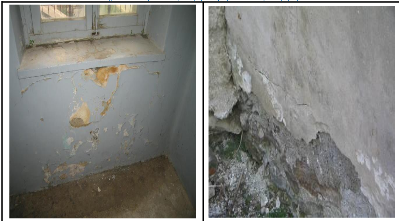
ΕΙΚΟΝΑ Δ4-14. Εκτεταμένη υγρασία, ελλιπής συντήρηση, αποκολλήσεις επιχρισμάτων τοπικού χαρακτήρα σε κατασκευή από φέρουσα τοιχοποιία. Βαθμονόμηση 25%.
