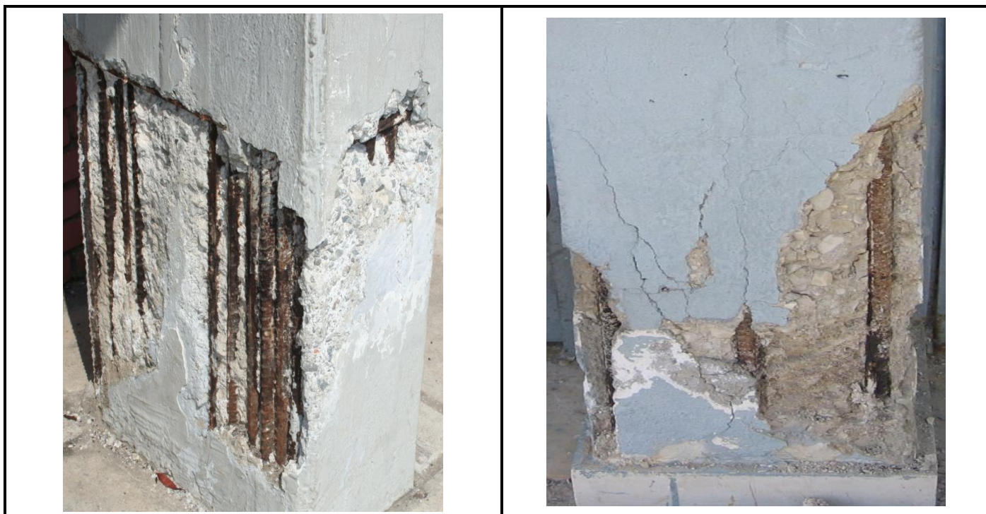
ΕΙΚΟΝΑ Δ4-10. Περιορισμένος βαθμός οξείδωσης σπλισμών. Απουσία συνδετήρων σε κρίσιμη περιοχή. Βαθμονόμηση ανάλογα με την έκταση του προβλήματος και το ποσοστό απομείωσης της διατομής των ράβδων.
