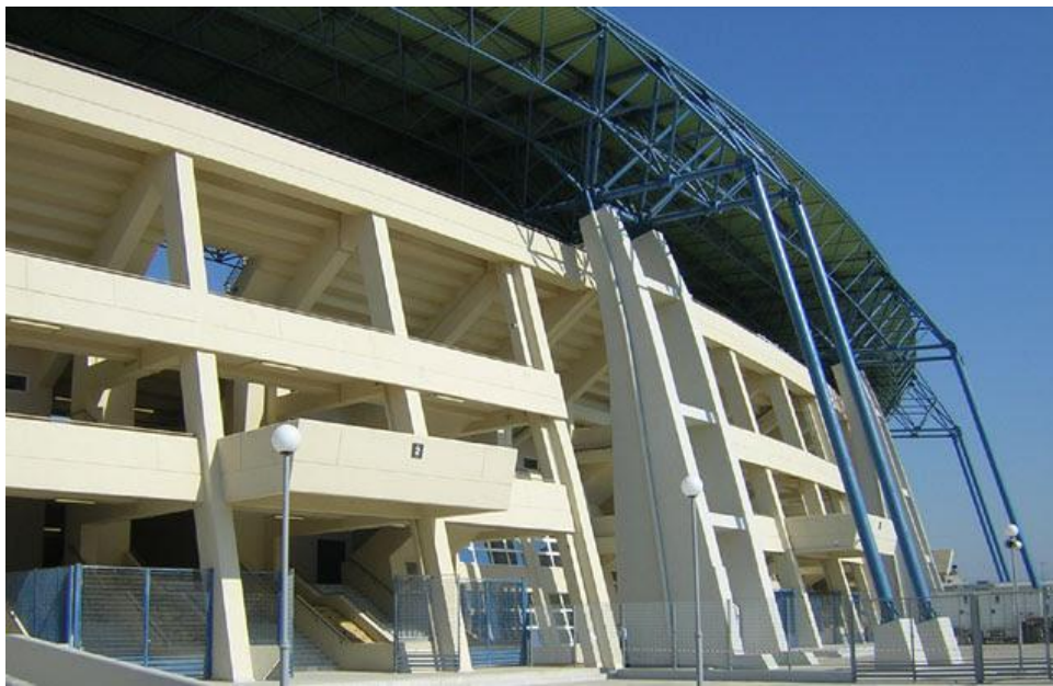
ΕΙΚΟΝΑ Δ1/2-3. Αυτοτελής κερκίδα από σπλισμένο σκυρόδεμα. Η στήριξη του στεγάστρου γίνεται σε αυτοτελή φέροντα οργανισμό, δηλαδή δεν συνδέεται με τον φέροντα οργανισμό της κερκίδας. Συντάσσεται ένα δελτίο για την κερκίδα και ένα για το στέγαστρο.
