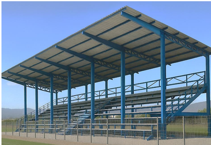
ΕΙΚΟΝΑ Δ1/2-5. Κοινός φέρων οργανισμός μεταλλικής κερκίδας και μεταλλικού στεγάστρου. Συντάσσεται ένα δελτίο για την κερκίδα και τα τμήματα των υποστυλωμάτων κάτω από αυτήν. Συντάσσεται ένα ακόμη δελτίο για το στεγάστρο με τα κατακόρυφα στοιχεία του, τόσο τα ανεξάρτητα εμπρός, όσο και τα πίσω μέχρι τις κεκλιμένες βαθμιδοφόρες δοκούς της κερκίδας.
