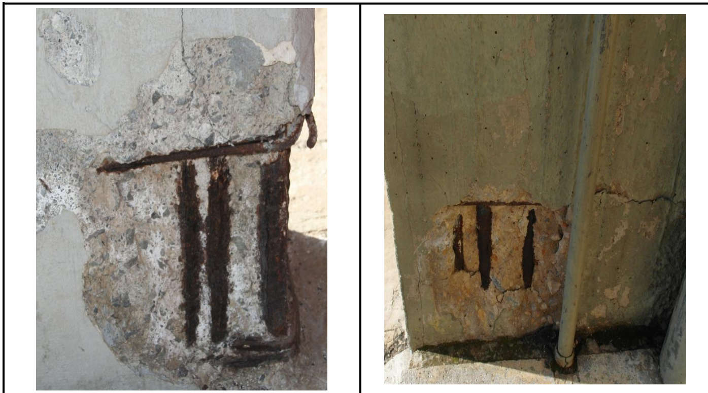
ΕΙΚΟΝΑ Δ4–11. Έντονη διάβρωση, απομείωση διατομής μεταξύ 20% και 40% σε δύο γειτονικούς στύλους. Βαθμονόμηση 75%.
