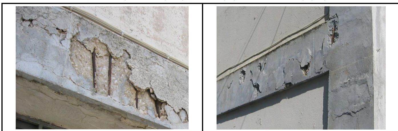
ΕΙΚΟΝΑ Δ4-9. Διάρρηξη – εκτίναξη της επικάλυψης σκυροδέματος. Ένδειξη για την επισταμένη διερεύνηση των κατακορύφων στοιχείων.
