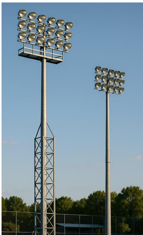
ΕΙΚΟΝΑ Δ3/3-1. Μεταλλικός πυλώνας φωτισμού.
