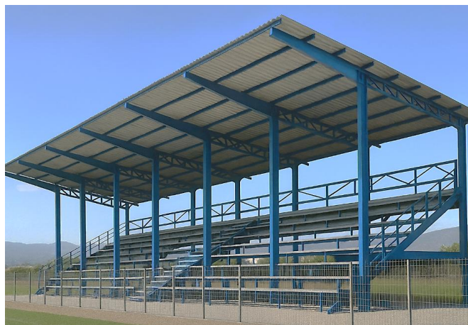
ΕΙΚΟΝΑ Δ1/3-2. Κοινός φέρων οργανισμός κερκίδας και στεγάστρου. Εξετάζεται η επίδραση του στεγάστρου επί της κερκίδας.
