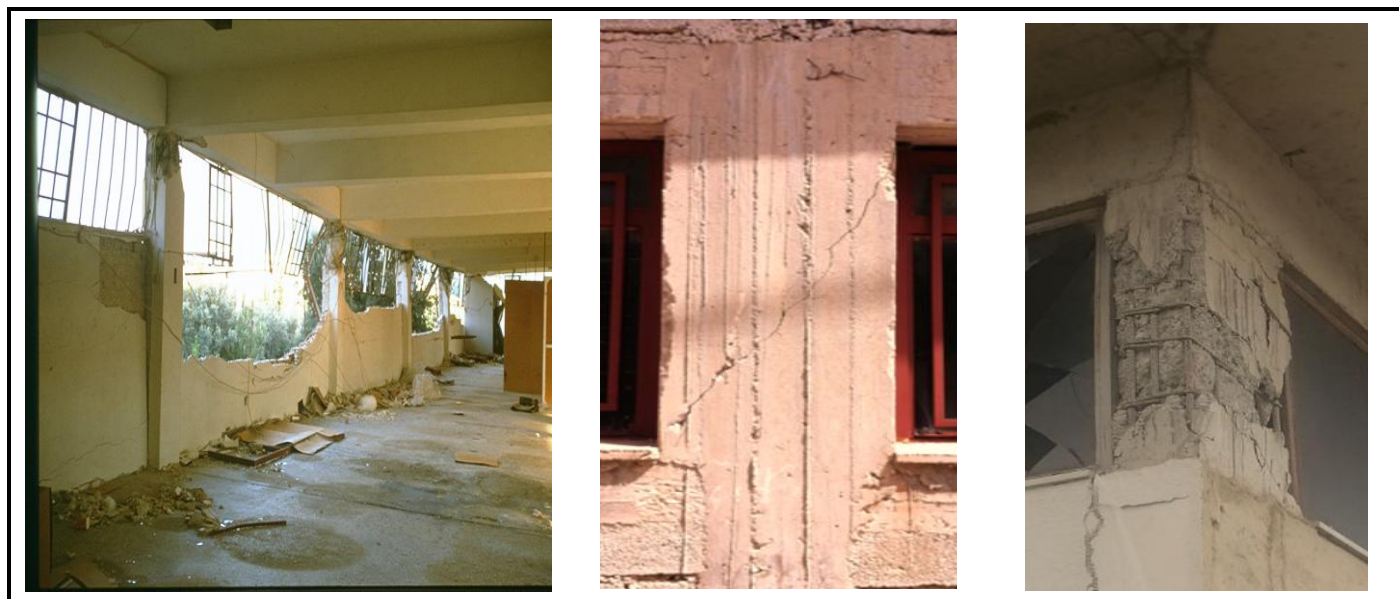
ΕΙΚΟΝΑ Δ4-24. Ψαθυρές αστοχίες «κοντών» υποστυλωμάτων.
