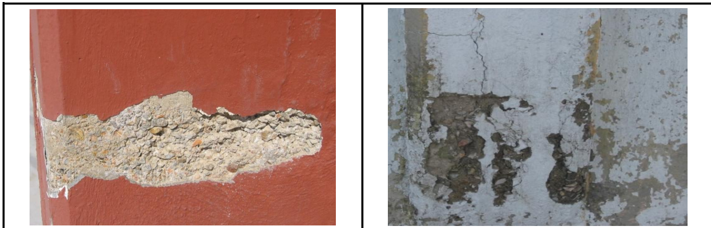
ΕΙΚΟΝΑ Δ4-8. Κακή κατάσταση (ποιότητα) σκυροδέματος. Στην Πίνακ αριστερά είναι εμφανής η εύκολη αποκόλληση των αδρανών. Βαθμονόμηση ανάλογα με την έκταση του προβλήματος.
